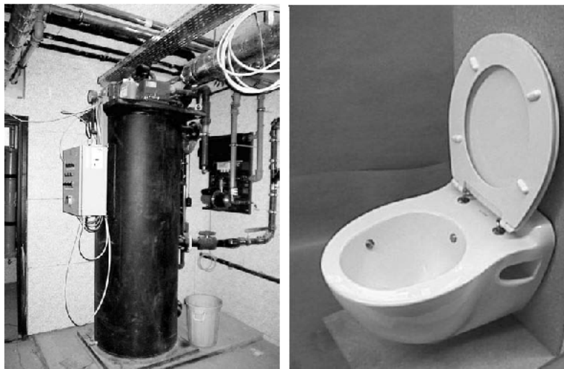
Vacuümpompstation en vacuümtoilet (Panesar en Lange, 2003)
