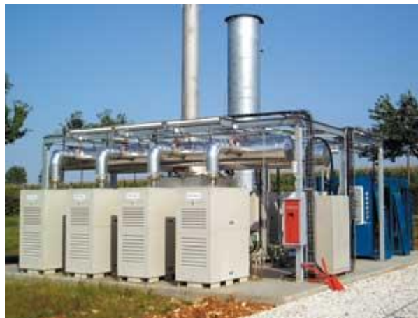
Batterij Capstone microturbines voor gebruik van biogas en CO 2 .
